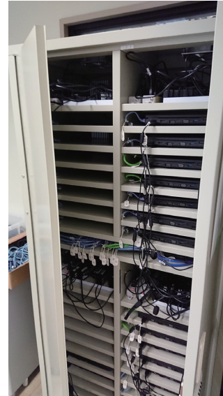
図4 8号館312室の専用ラック
